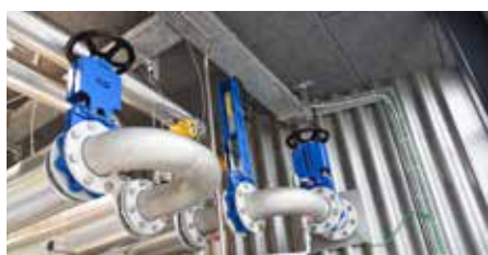
En el tanque de digestión, el lodo se recircula a través de un intercambiador de calor.
